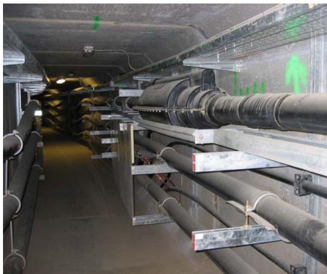
Bild 8: 380-kV- Tunnelbauwerk mit Kabelmuffe; Flughafen Madrid
