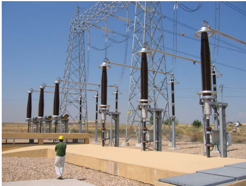
Bild 3: Übergang von zwei 380-kV-VPE-Kabeln auf eine Freileitung; Kabelendverschlüsse und Überspannungsableiter; Flughafen Madrid
